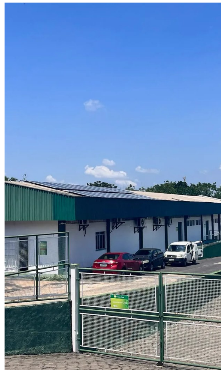
Painéis solares instalados sobre o telhado do galpão principal.
